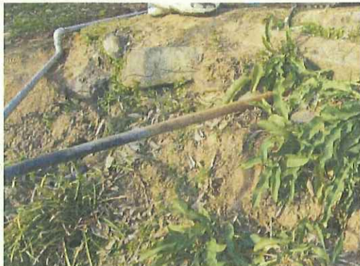
1. 漏れた箇所（地中埋設管の腐食）
