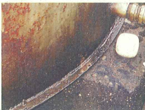
1. 重油タンクの腐食
