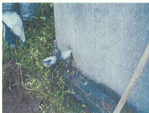
2. 防油堤のひび割れとバルブ
